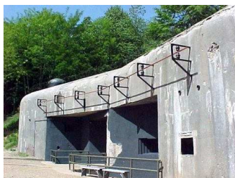
Antenne en façade de bloc http://www.lignemagnot.com
